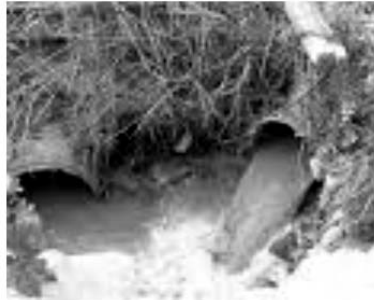
Esgoto depositado em lagoa
